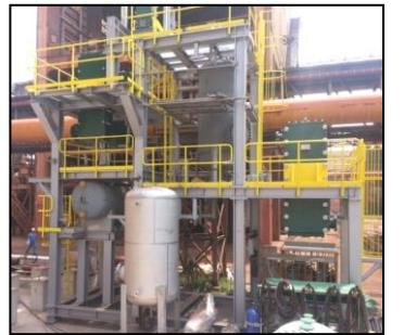
焼結炉排熱発電：発電量600kW
